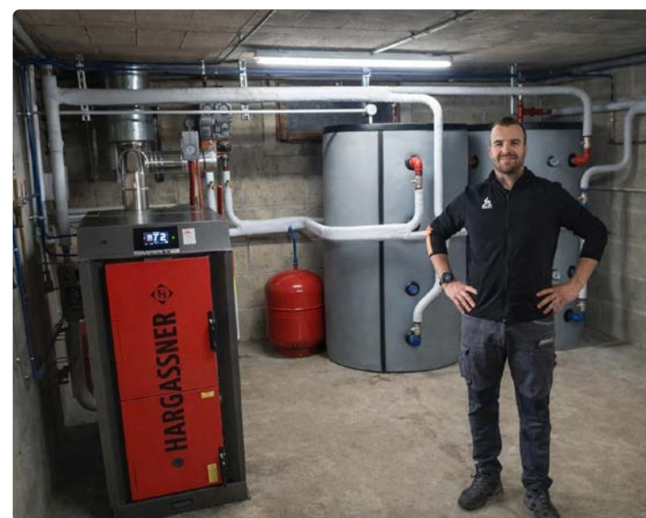
Montigny-lès-Cherlieu. Dylan Mignot propose l'installation, le dépannage et l'entretien de chaudières, poêles et climatisations, ainsi que des travaux de plomberie et de sanitaire.
